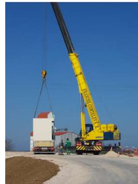
Livraison d'un nouveau poste de transformation
