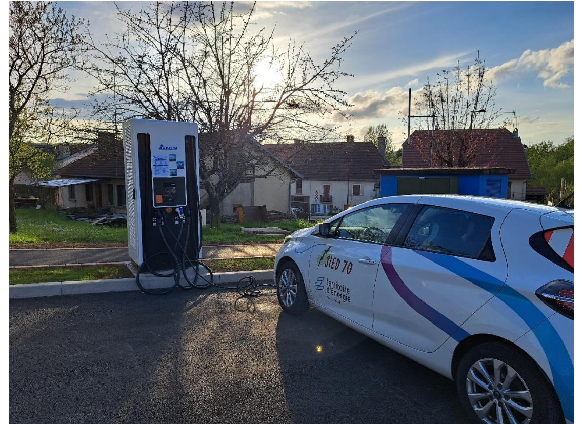
Borne installée à Rioz
