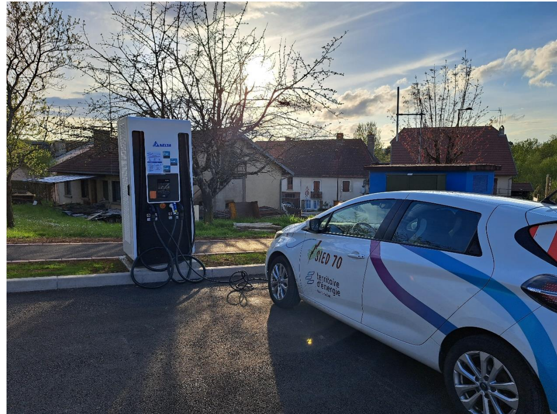
Borne installée à Rioz
