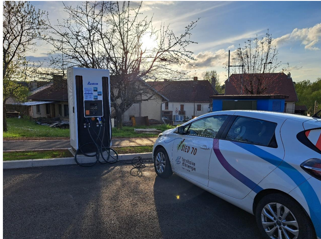
Borne installée à Rioz
